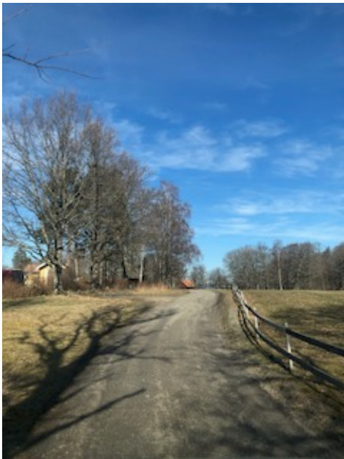
Bollplansvägen 6-10, lite slitlager bör kompletteras
