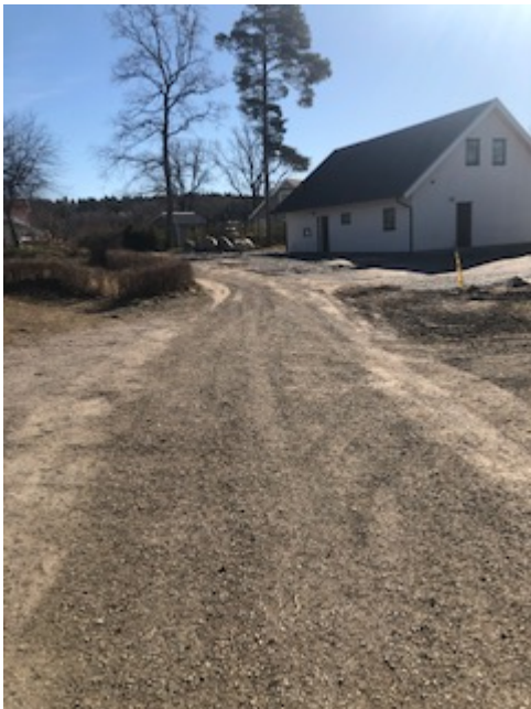
Kristin Ribbingsväg 61 Väg skadad pga. Husbyggnation, bör åtgärdas av husägaren.
