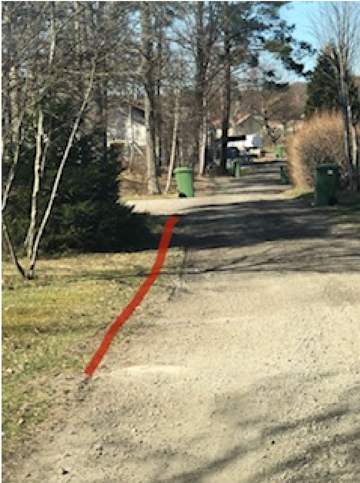
Källarbacksvägen 5, vänster sida, kantskår
